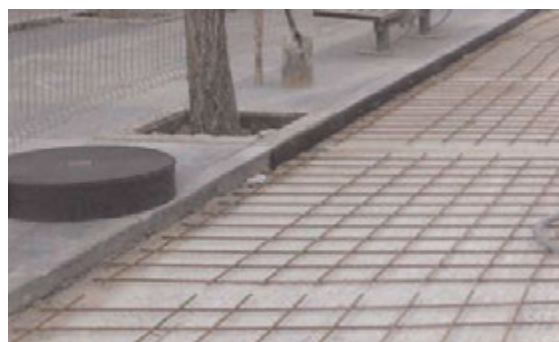
Figura 16. Colocación de elementos compresibles contra bordillos, muros y zapatas para consecución de la junta de dilatación.
