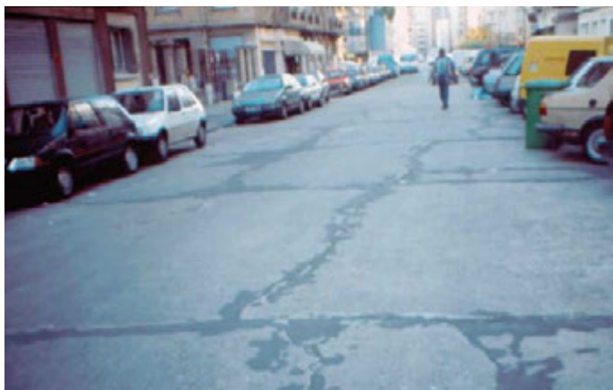
Figura 1. Fisuración en un pavimento de hormigón sin juntas.
