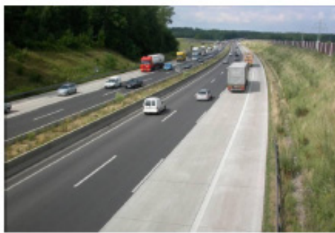
Ensanche de un firme bituminoso mediante un carril y un arcén con pavimento de hormigón
